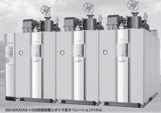
SQ-3000AS×3台密接設置とボイラ室オペレーションパネル
